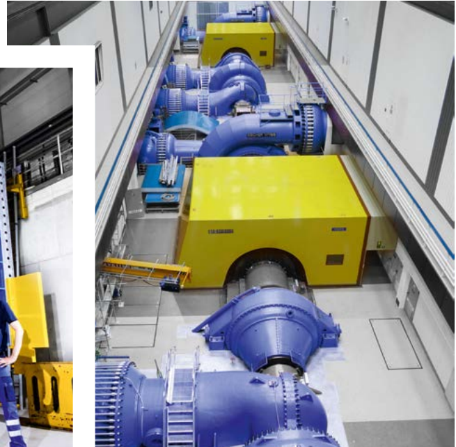
4台の発電ユニットを備えたWehrは、Schluchseewerk AGのポートフォリオの中で最大の発電所であり、重要なグリッド バランシング サービスを提供しています。
