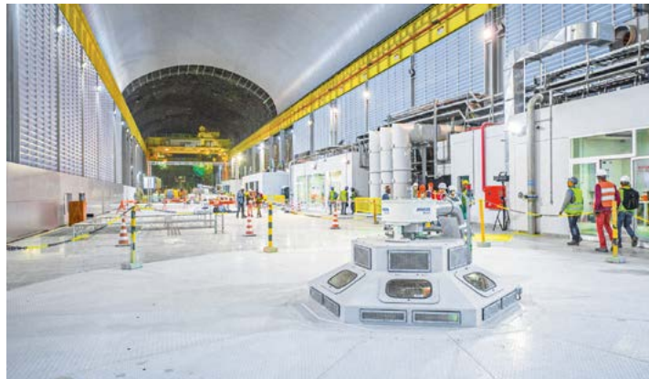
主発電所は長さ 270 m を超え、それぞれ定格出力 335 MW の 6 つのユニットを備えています。
