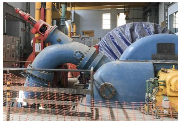
Detalhe da casa de força danificada
