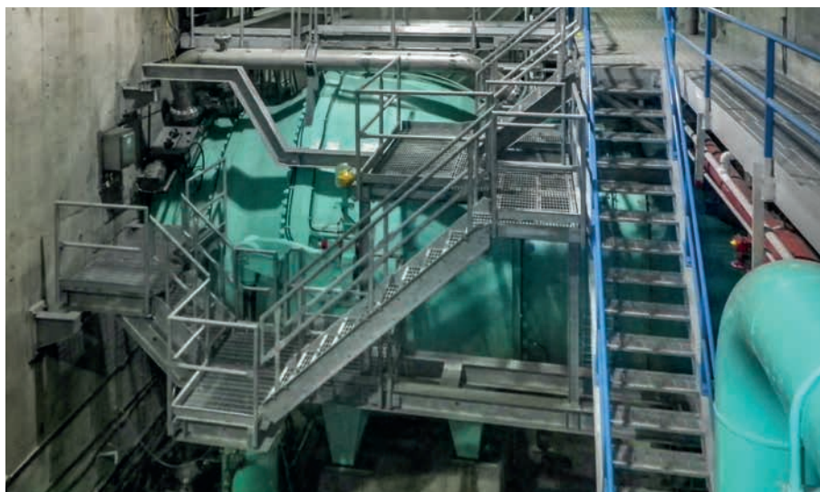
Les vannes existantes
