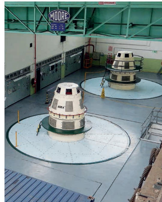
La salle des machines de la CHE de Catagunya
