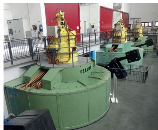
La salle des machines
