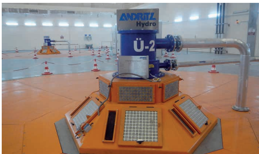
La salle des machines
