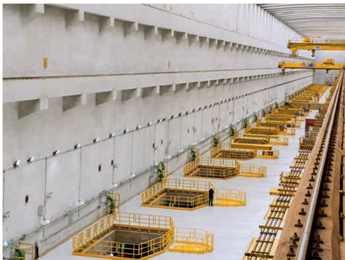
La salle des machines
