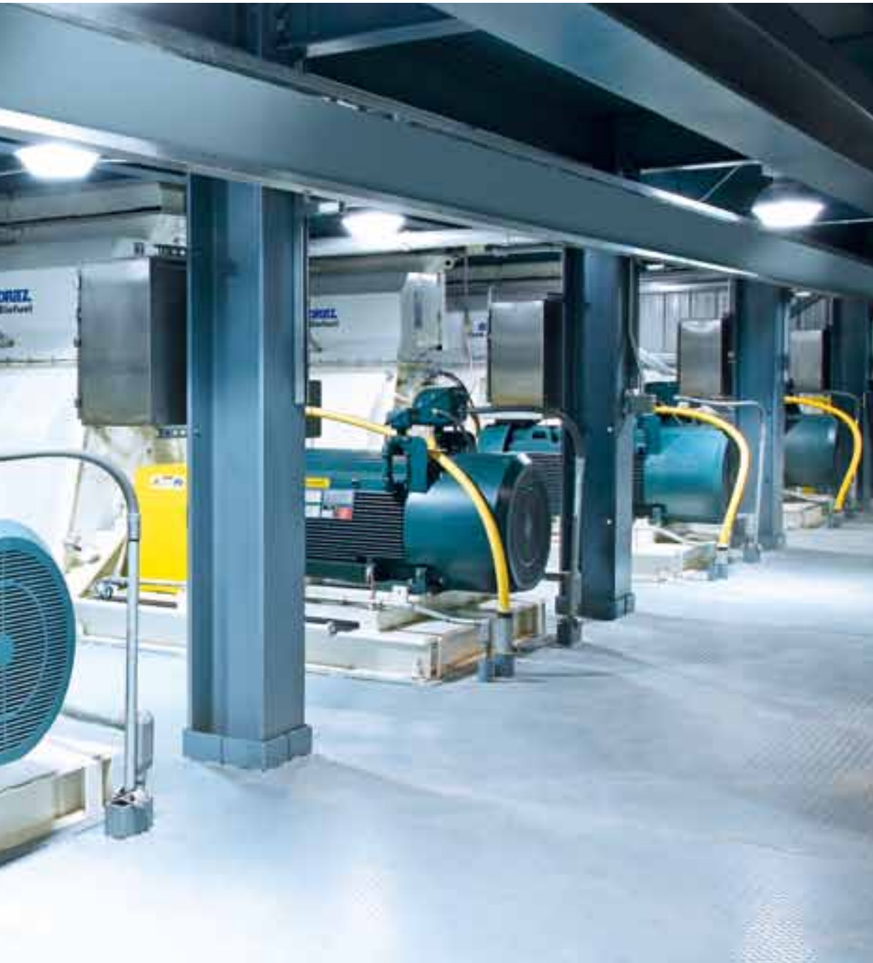
Ausbau erneuerbarer Energie: Die größte Holzpelletierungsanlage Nordamerikas wurde im Auftrag von RWE Innogy, dem Unternehmen für erneuerbare Energien innerhalb des deutschen RWE-Konzerns, erfolgreich in Betrieb genommen.
